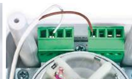
Фото 15. Подключение датчика к электроприводу
